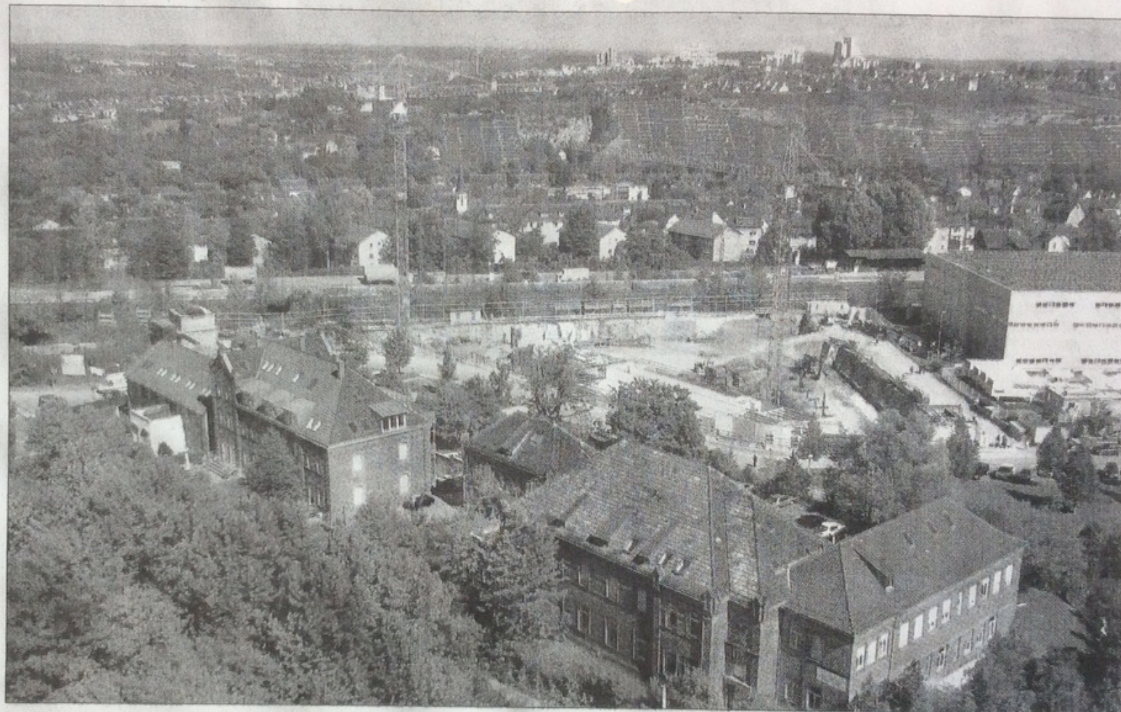
Der Neubau für die BiL-Privatschule neben dem Kulissenlager des Staatstheaters nimmt langsam Gestalt an. Teile des Untergeschosses sind bereits sichtbar. In einem Jahr soll der Schulbetrieb aufgenommen werden. Foto: Rehberger
